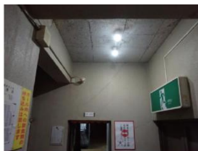
内壁ひび割れ
