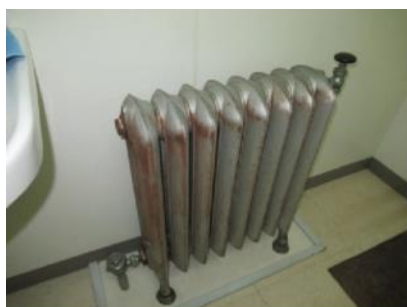
旧式の暖房設備
