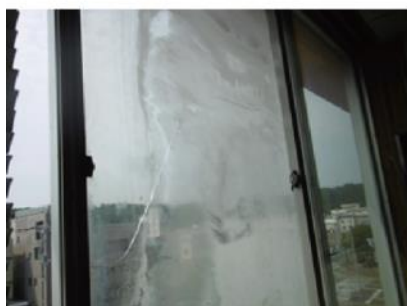
割れている窓
