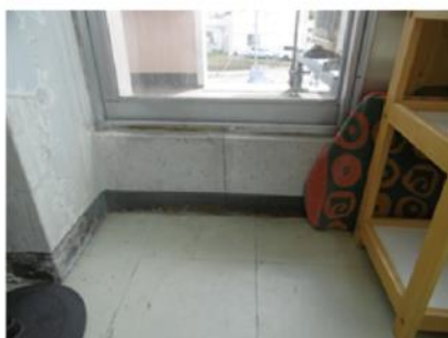
窓廻りの老朽化と 窓下のひび割れ
